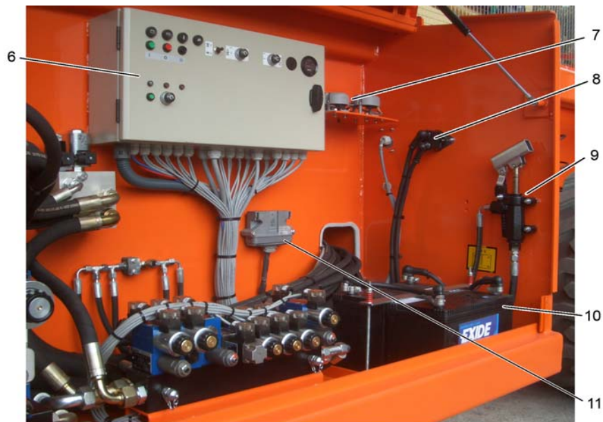
Ventielen en generator
